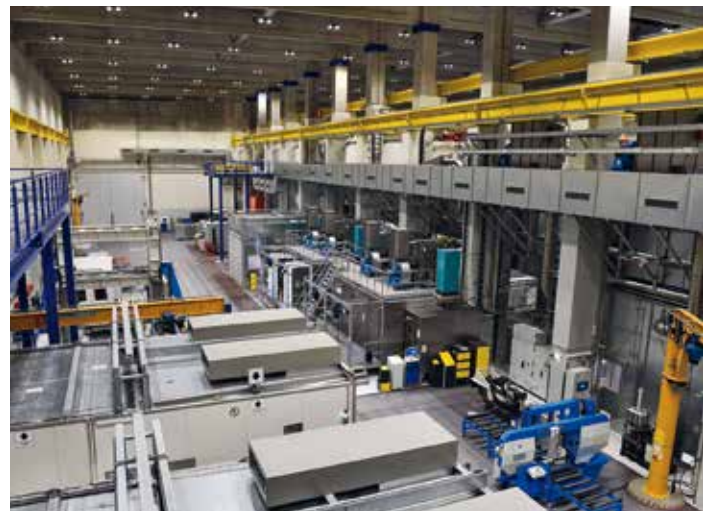
Das Reststoffbearbeitungszentrum Philippsburg. Foto: EnBW
